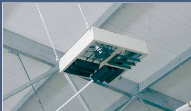
установка подпотолочного вентилятора
